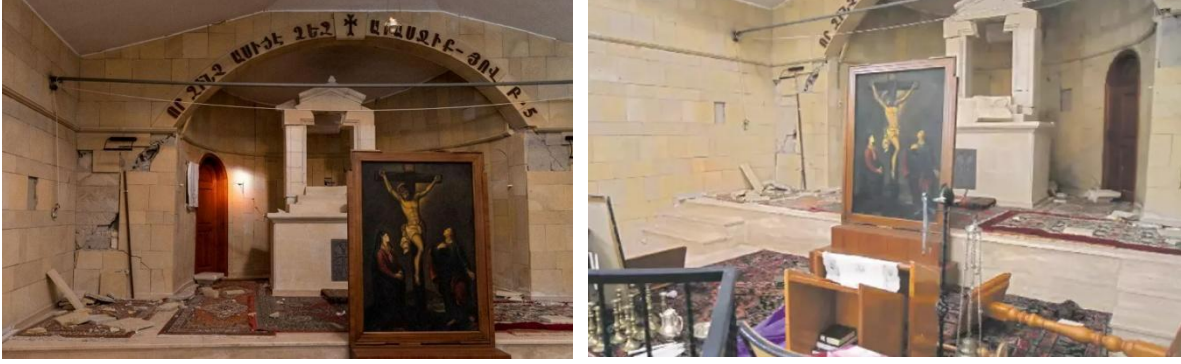
Şekil 7. Surp Asdvadzadzin Kilisesi'nin 2023 Depremleri Sonrası Hali (URL-2, URL-3).
